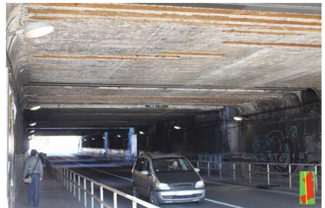
S-Bahnhof Bochum Langendreer / B 235 Angstraum / instandsetzungsbedürftige Brücke
